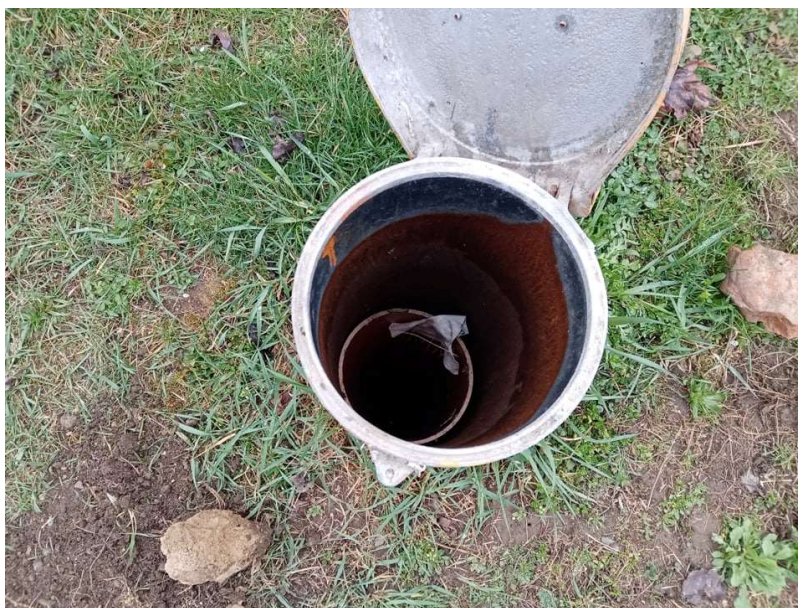
Obr. 2.1.2-1: Snímek poškozeného bodu 103 (1.4. 2022)
