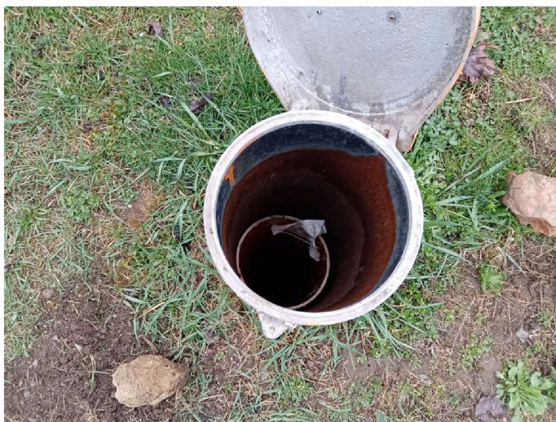
Obr. 2.1.2-1: Snímek poškozeného bodu 103 (1.4. 2022)
