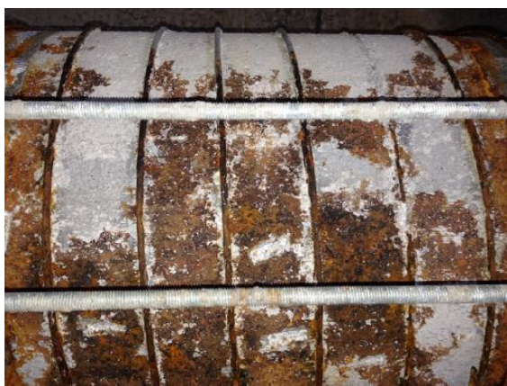
Obrázek č. 32: Korozní stav spirálových tyčí [28]
