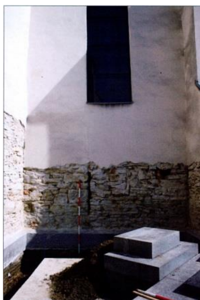
Karviná – Fryštát, kostel Povýšení sv. Kříže, spára mezi opěrákem (vlevo) a připojeným zdivem jižní kaple (vpravo), 1. čtvrtina 15. století
