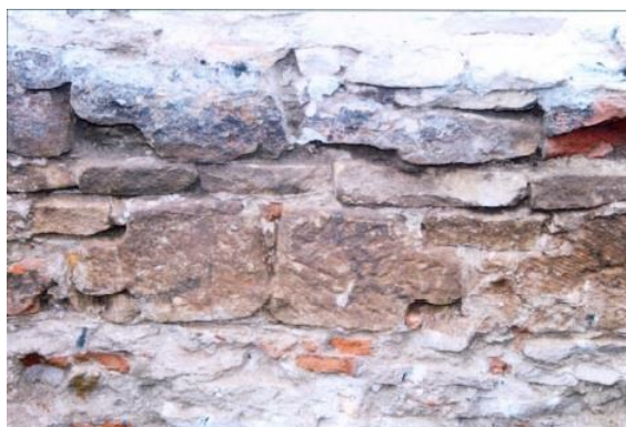
Karviná – Fryštát, kostel Povýšení sv. Kříže, základové obvodové zdivo klasicistní sakristie – dílce hruškových klenebních žeber, 2. polovina 15. století
