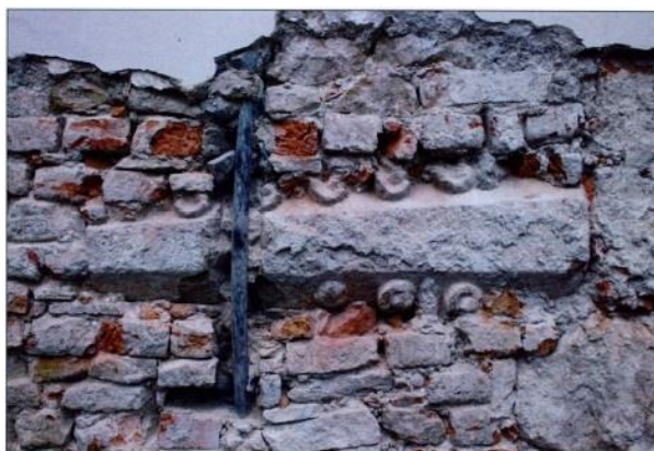
Karviná – Fryštát, kostel Povýšení sv. Kříže, nadzemní obvodové zdivo klasicistní sakristie – fragment gotické fiály, 2. polovina 15. století
