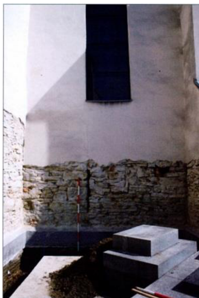
Karviná – Fryštát, kostel Povýšení sv. Kříže, spára mezi opěrákem (vlevo) a připojeným zdivem jižní kaple (vpravo), 1. čtvrtina 15. století
