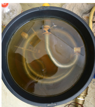
Obr. 16: Pohled na výměník TUV
