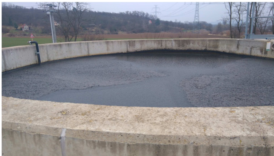
Obr. 7.1 Otevřená vyhřívací nádrž ČOV Ledce
