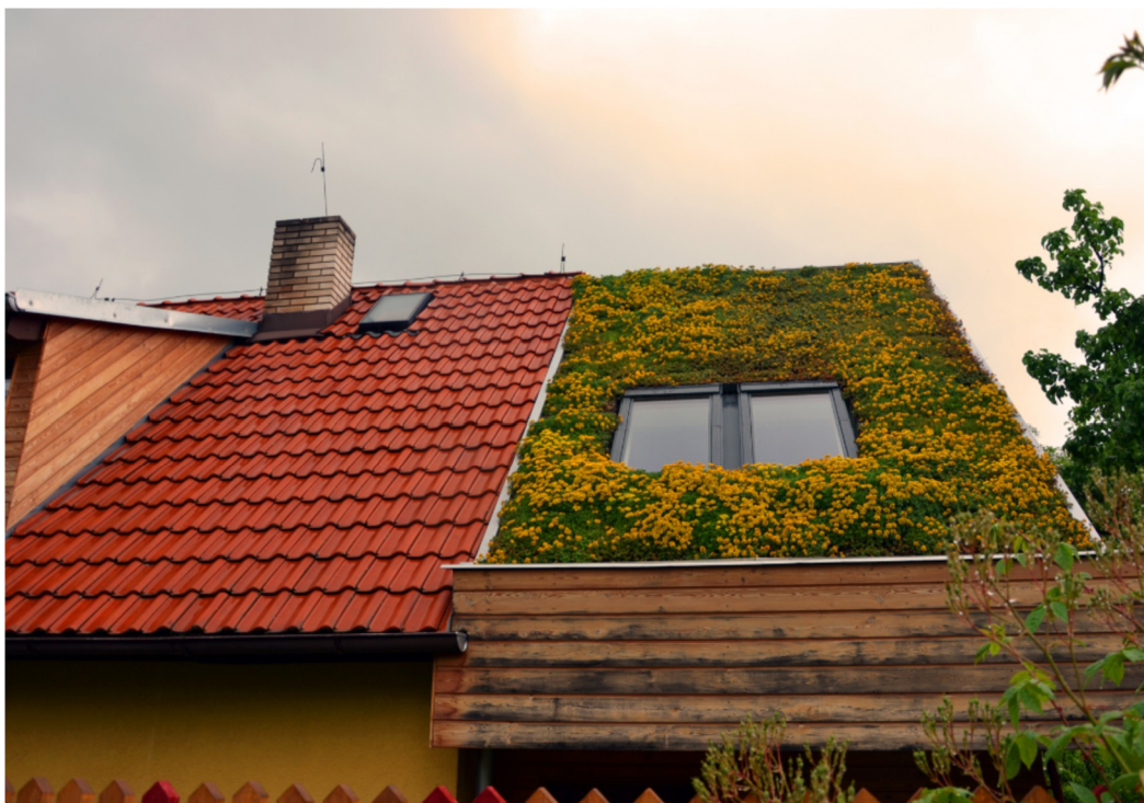
Obr. 9 – Šikmá extenzivní zelená střecha na rodinném domě v okrese Praha-západ. Vegetaci tvoří rozchodníky, netřesky a pažitka v předpěstované voštině. Zdroj: SZÚZ 2019
