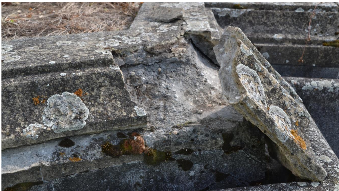
Obr. 20 Poškozená římsa bazénu.
