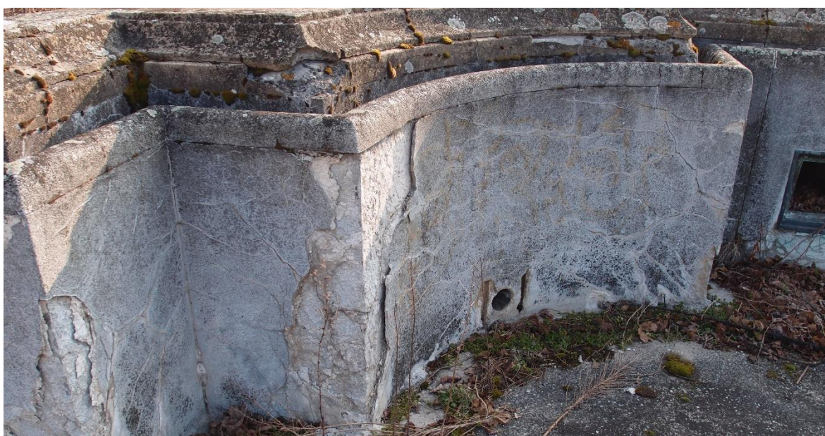
Obr. 17 Degradace teraca na svislé stěně.
