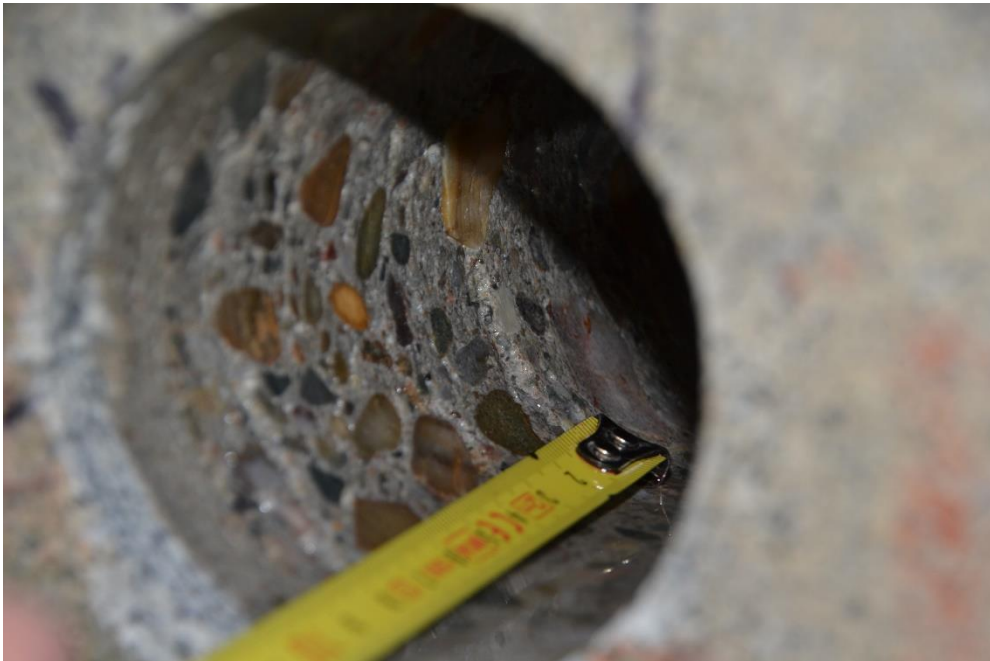
Obr. 41 Dokumentace trhliny v otvoru po jádrovém vrtání.
