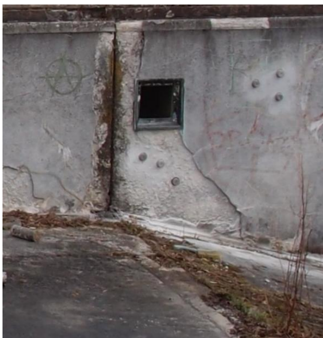
Obr. 15 Celkový pohled na stav dilatační spáry.
