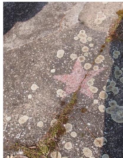
Obr. 19 Dno bazénu – vysprávký.
