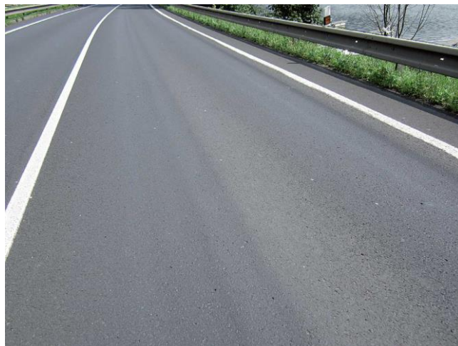
Obr č. 7 Vyjeté koleje ve špatné asfaltové směsi [9]
