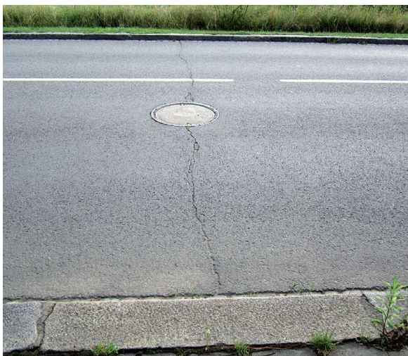
Obr. č. 5 Trhlina příčná úzká [1]
