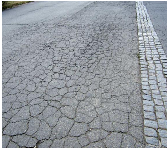
Obr. č. 4 Sít'ová trhlina [1]
