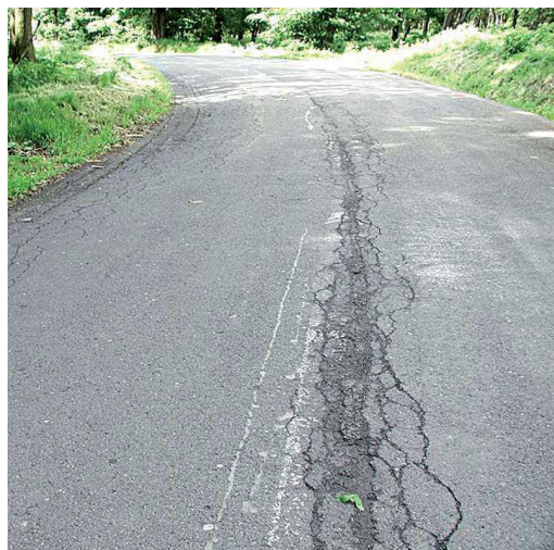
Obr. č. 6 Trhlina podélná rozvětvená [1]
