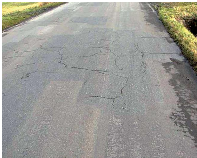
Obr č. 3 Mozaiková trhlina [1]
