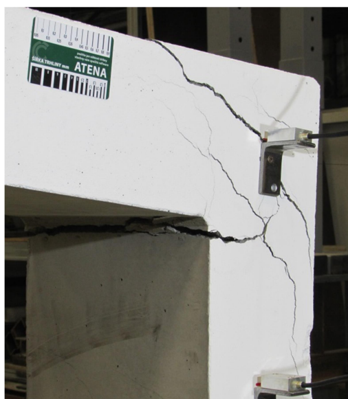
Obr. 5.4.9: GFRP A - III – porušenie prvku
