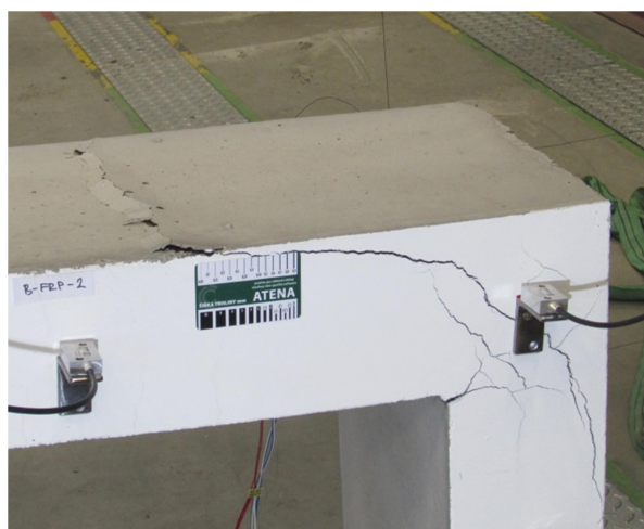
Obr. 5.4.18: GFRP A - I – porušenie prvku
