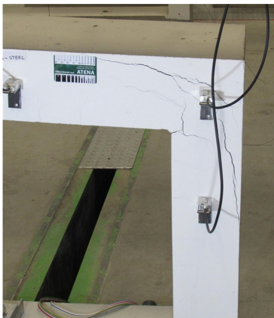
Obr. 5.4.5: ŽBA – rozvoj trhlín
