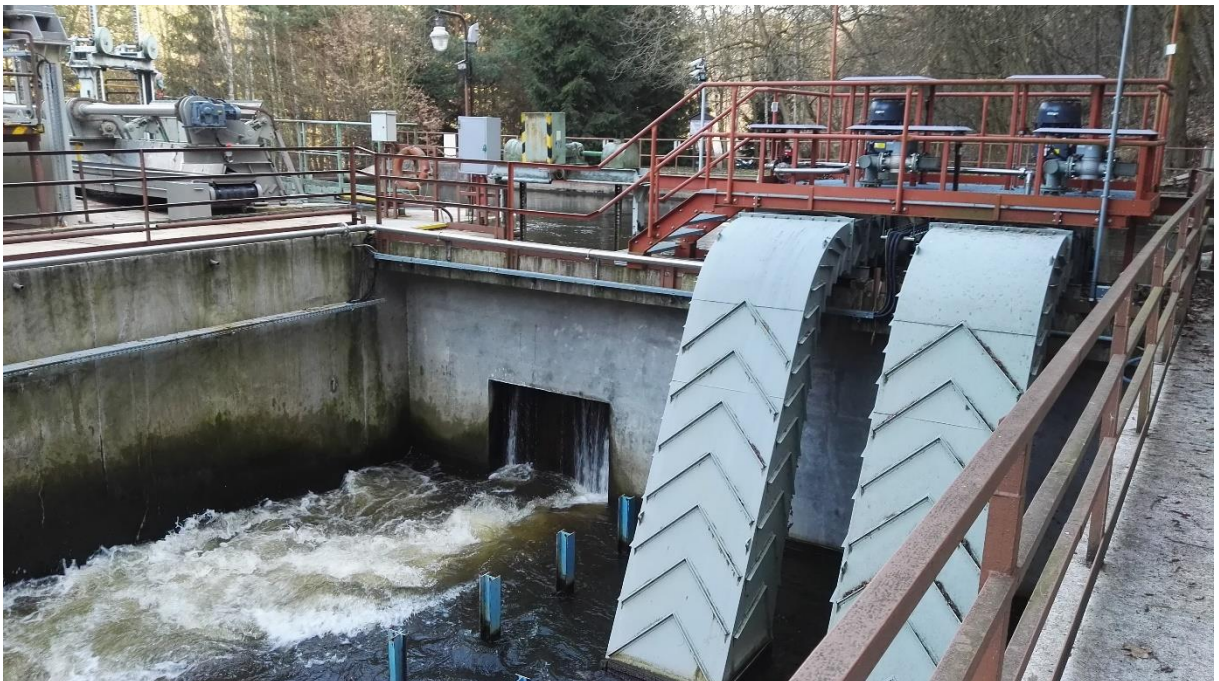
Příloha 4 Automatické stavidlo Lomazického kanálu
