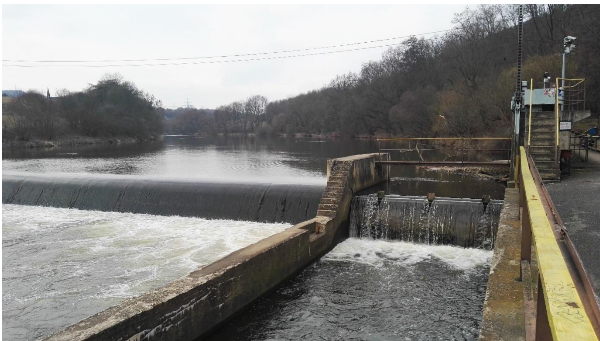
Obr. 16 Vzdouvací zařízení pro MVE Želina; vlastní zdroj
