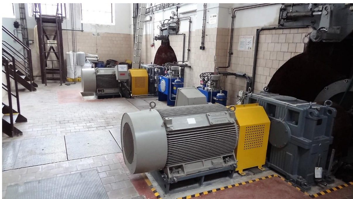
Obr. 19 Strojovna s generátory značky Siemens; vlastní zdroj
