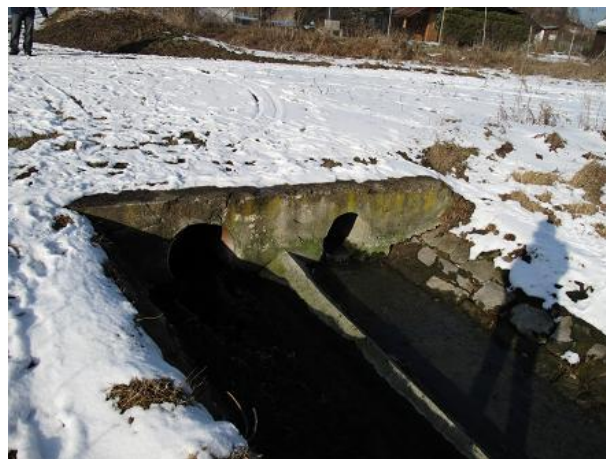
Obrázek číslo 24. Výpust' z ČOV do Ohře
