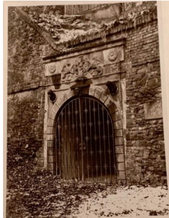
Obr. XIII. Situace při osazení portálu v hradebním zdivu ve východním vstupu do tzv. Letního divadla
