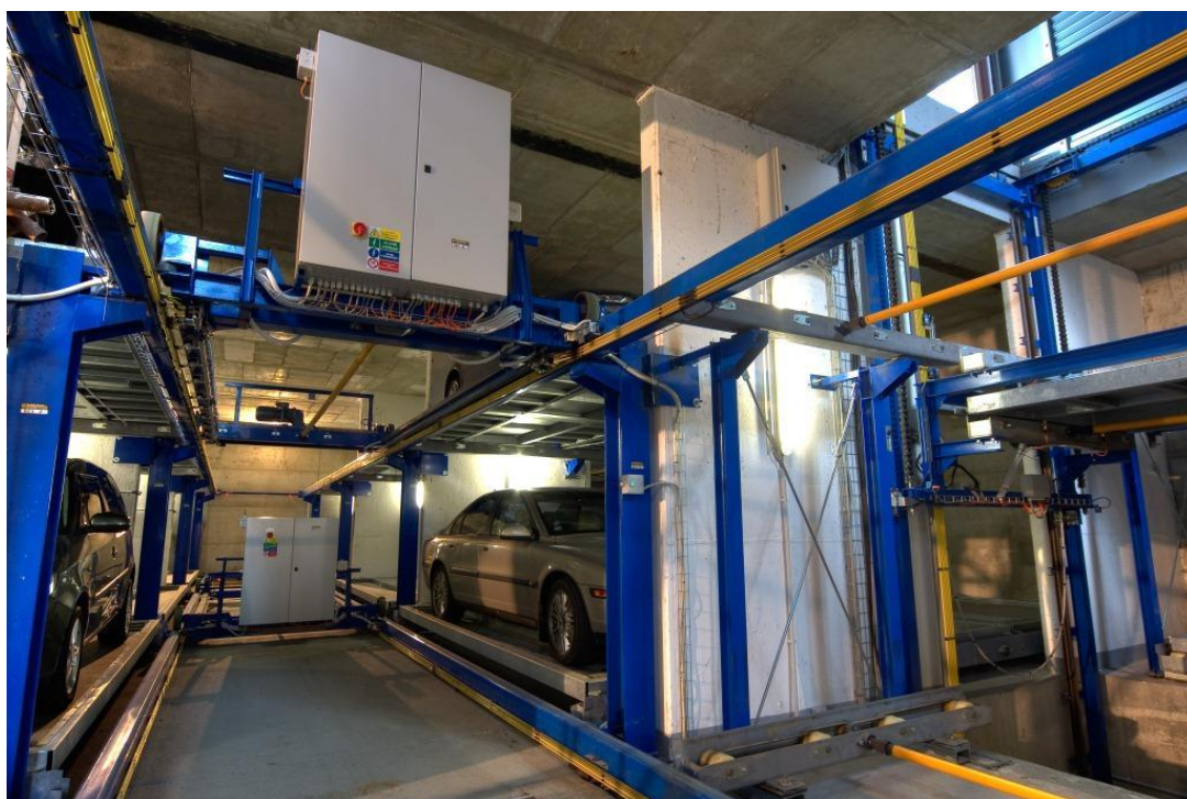
Příloha P7: Výtahová šachta a dopravníky [Vlastní foto]
