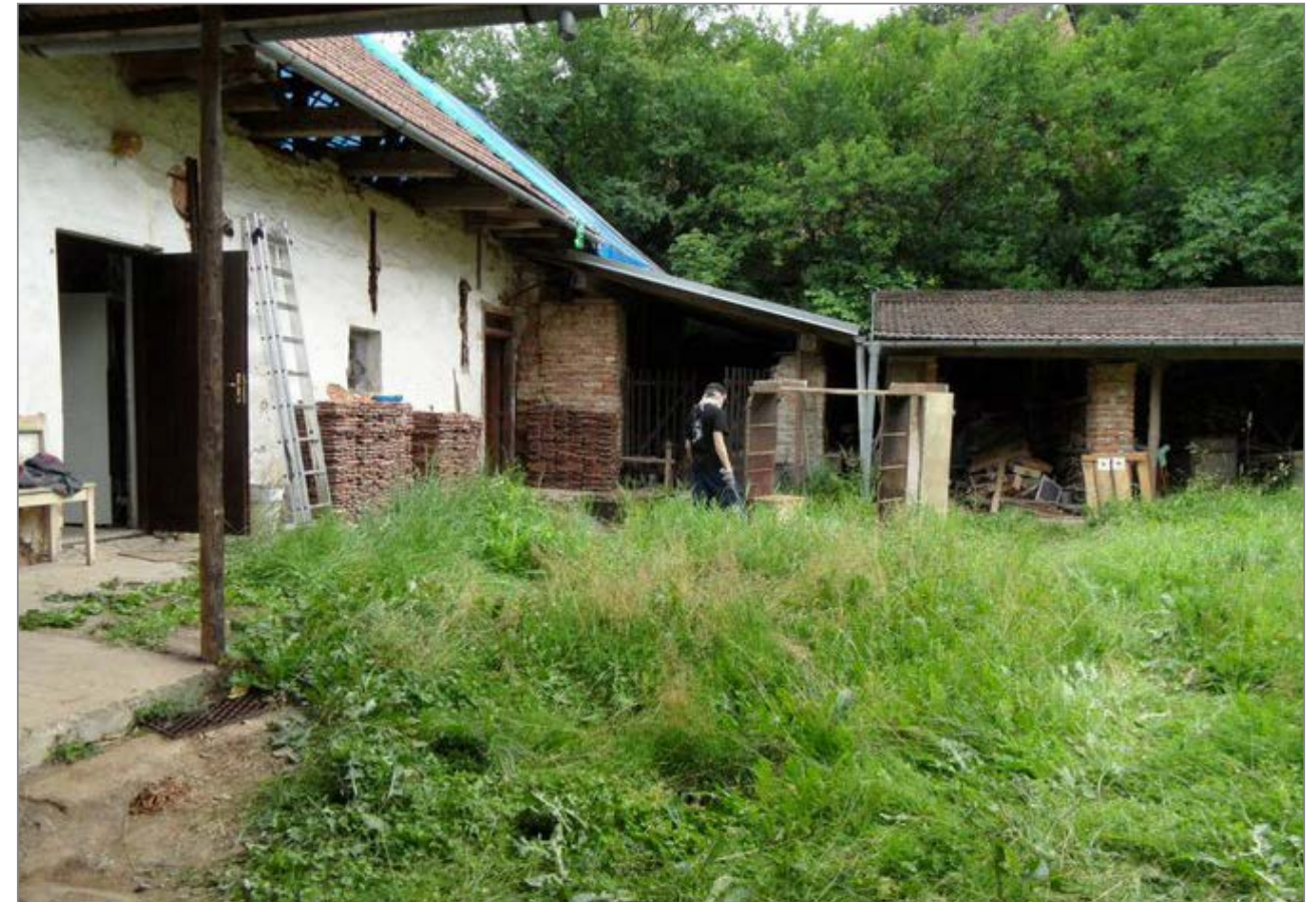
střecha ve velmi špatném stavu
