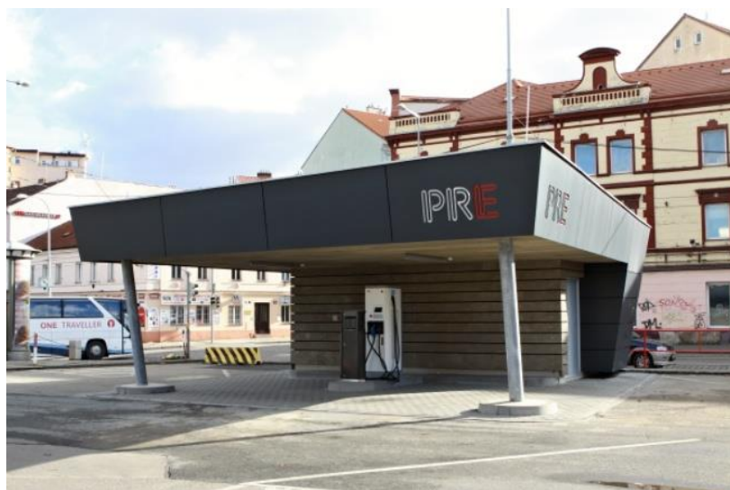
Obr. 32 Nabíjecí stanice PRE v Praze. [66]
