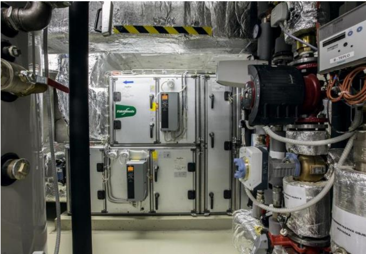
Obr. č. 21 Pohled do hlavní strojovny celé soustavy [21]
