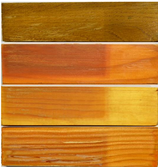
Příloha 1. Obr. 1 „5. stupeň odlupování (poškození do 35% vystavené plochy)“; DB, MD, SM, DG
