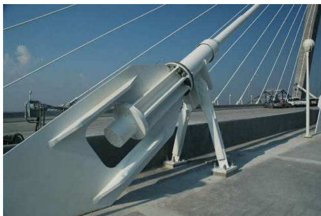
Obrázek 2.16: Kabel upevněný na mostovce mostu Arthur Ravenel Jr. Bridge 11
