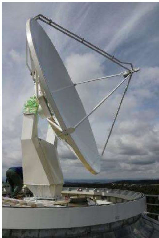
Obrázek 2: Anténa radaru Vaisala WRM200 umístěná na radarové základně Skalky u Protivanova. [7]
