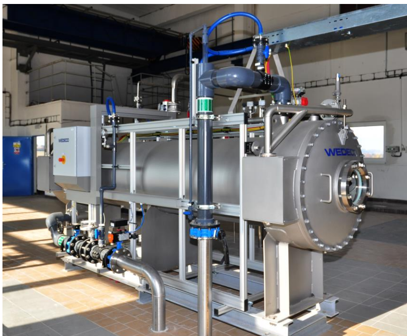
Obr. 6. 5 Ozonizace na úpravně vody Želivka [31]
