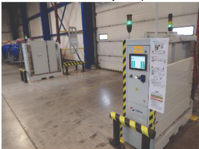
Obrázek č . 26: Detekční rám systému pro radiační monitoring na LVH Praha
