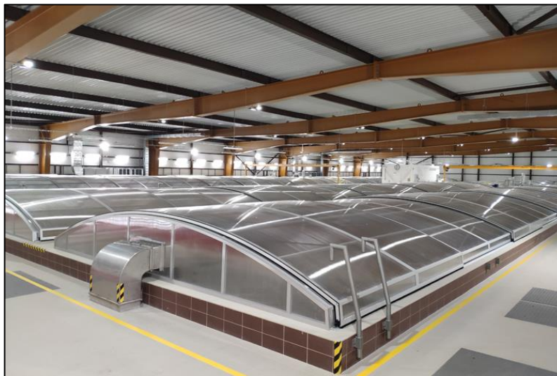
Obrázek 10: Hala filtrů GAU filtrace (Sweco, 2022).
