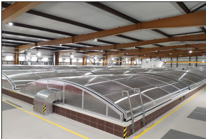
Obrázek 10: Hala filtrů GAU filtrace (Sweco, 2022).
