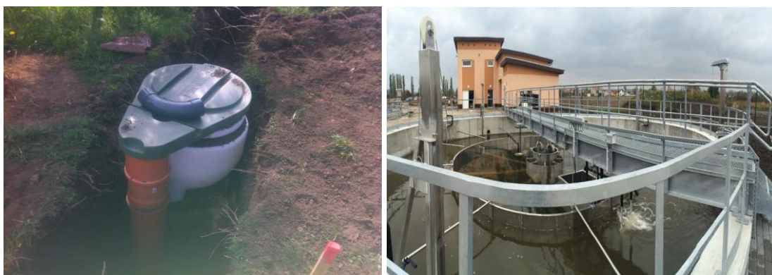
Obr. č. 1: Sběrný tank a ČOV Šaratice (foto Litava-DSO, 2015)
