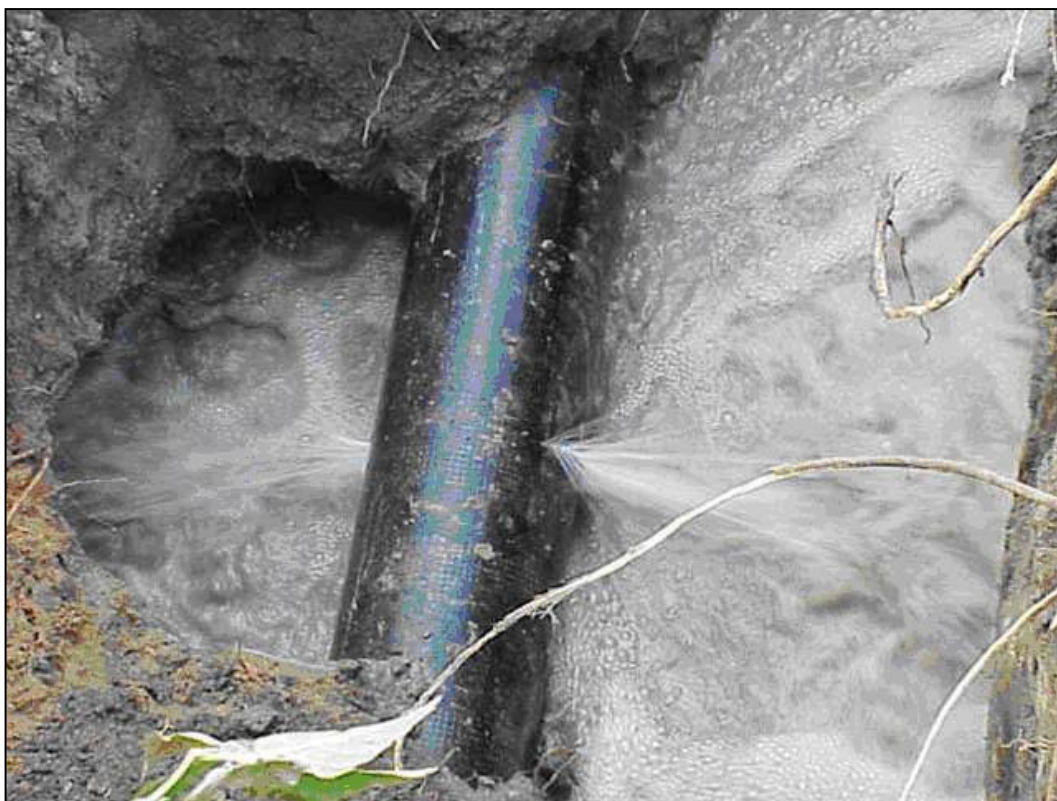
Obr. 3.7 - Příčný lom a následný únik vody ( http://www.allianceforwaterefficiency.org 2014)
