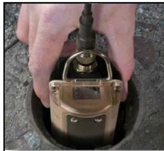
Obr. 7.5 - Instalace snímače šumu na šoupě (URL 21)
