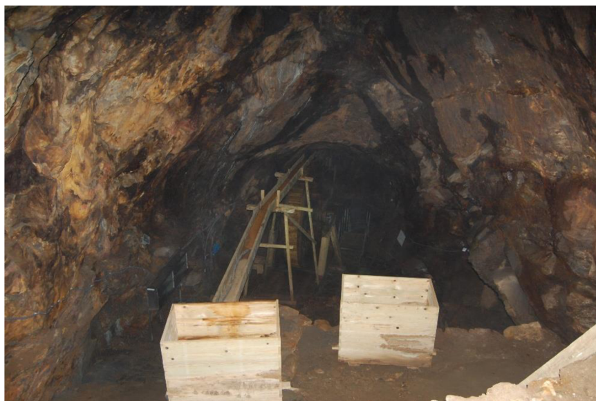
Obr. 39. Pohled na část vodotěžního zařízení v Poštovní štolě (foto: M. Petřek).
