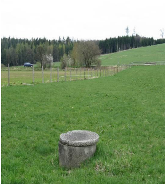
Foto č. 18 Revizní šachta na drenážním systému.
