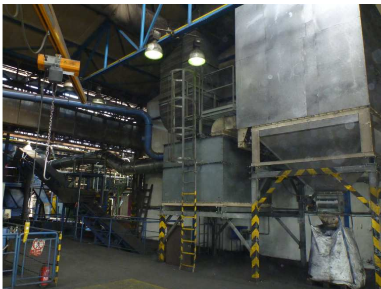
Obr.4-11 Technologická linka – ukončení tryskačů
