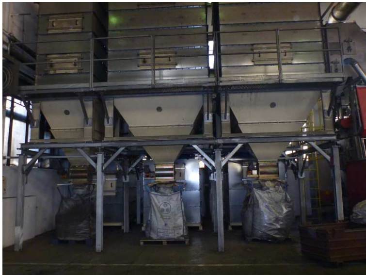
Obr.4-5 Pneumaticky oklepávané filtry, akumulace do plátěných pytlů
