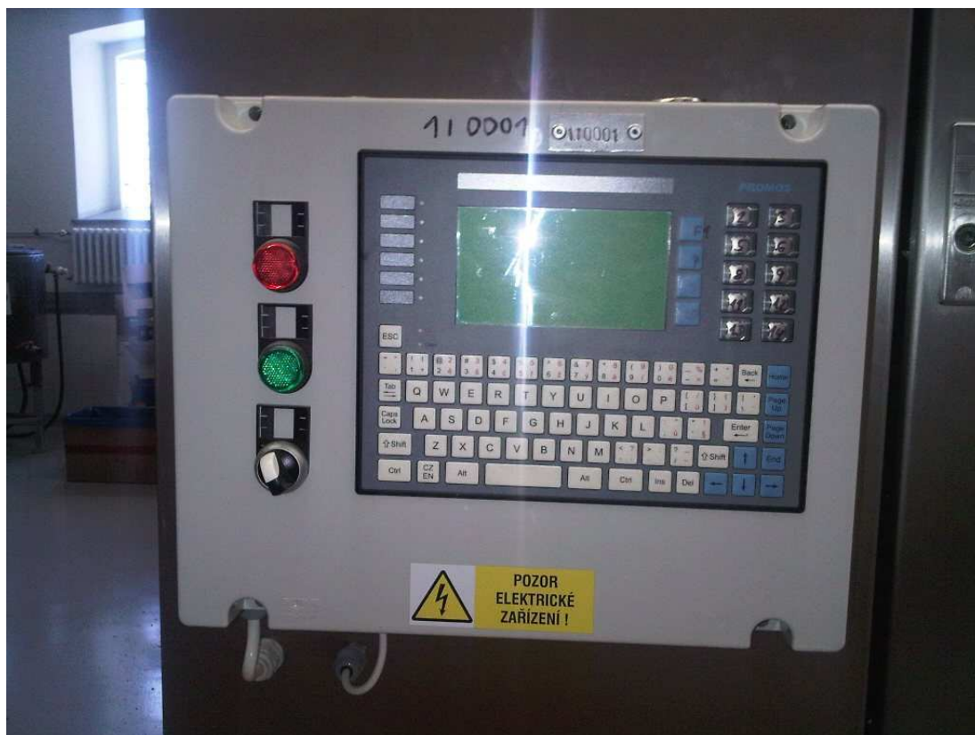
Obr. 30 Aplikované zařízení – čelní pohled [14]
