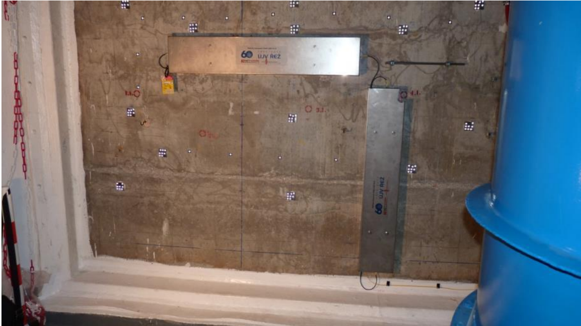
obr. 3.11 Umístění vertikálního a horizontálního senzoru pro měření tvarových změn na kontejnmentu jaderné elektrárny Temelín.
