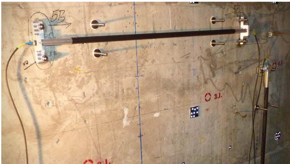
obr. 3.10 Umístění vertikálního a horizontálního senzoru bez ochranného krytu pro měření tvarových změn na kontejnmentu jaderné elektrárny Temelín.
