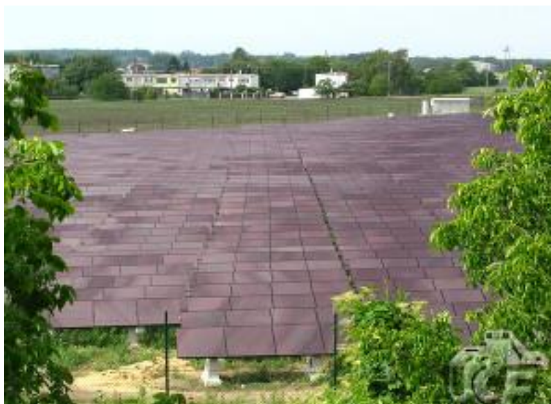
Obr. 3.1.1: Fotovoltaická elektrárna Hrušovany nad Jevišovkou [2]
