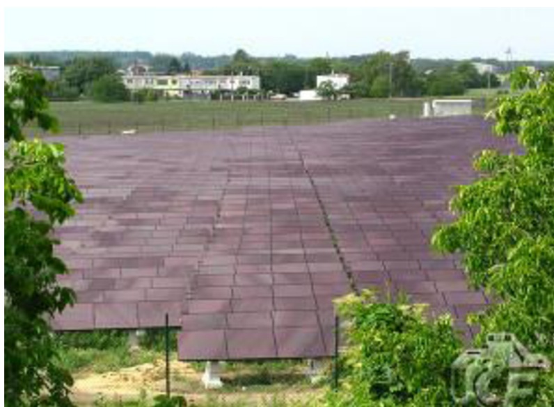
Obr. 3.1.1: Fotovoltaická elektrárna Hrušovany nad Jevišovkou [2]
