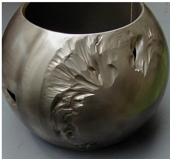
Obr. 20 Erozivní opotřebení koule uzávěru ( http://degradace.tf.czu.cz )
