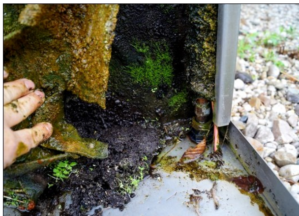
Foto č. 5.2.C - Vyplavování živin a substrátu, spodní část stěny, Buštěhrad
