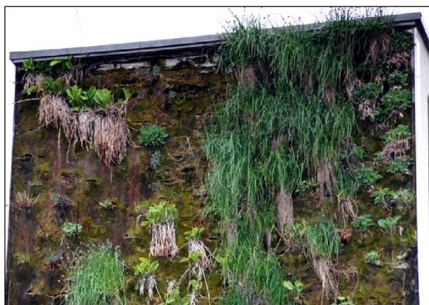
Foto č. 5.2.D - Horní část stěny, Buštěhrad
