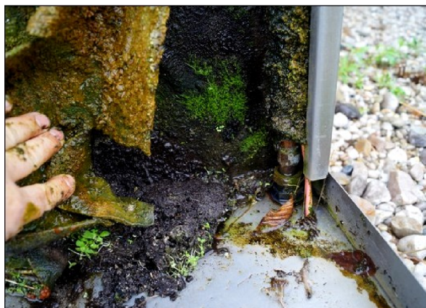
Foto č. 5.2.C - Vyplavování živin a substrátu, spodní část stěny, Buštěhrad
