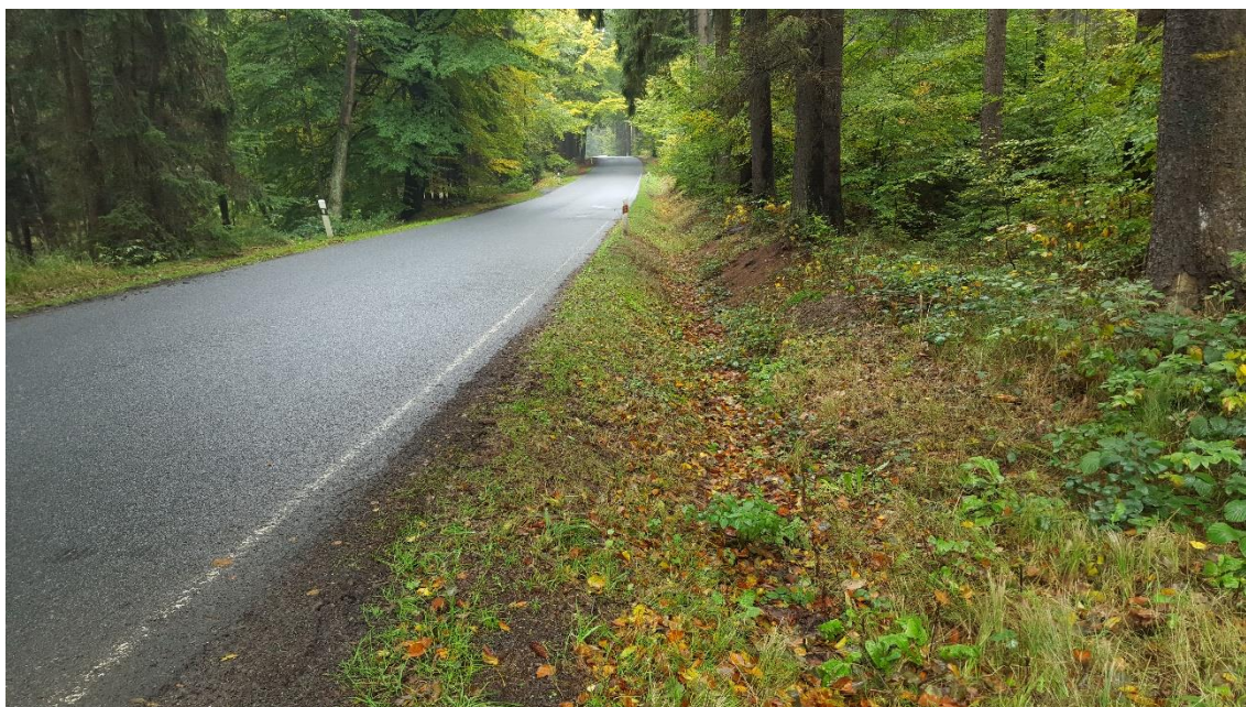
Obrázek 16: Zanesený příkop u asfaltové vozovky.
