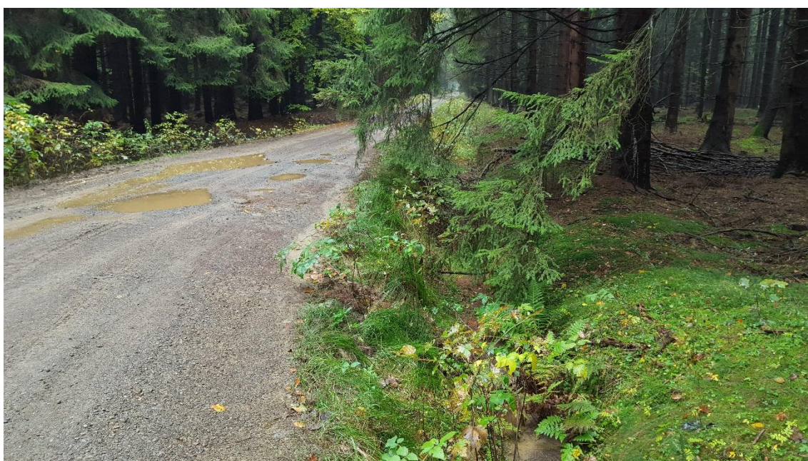
Obrázek 17: Porušená koruna vozovky a zanesený příkop.
