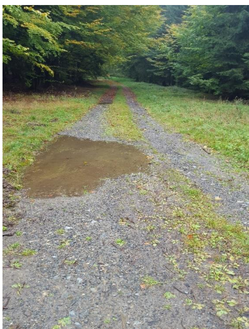
Obrázek 12: Usazující se voda na cestě.
