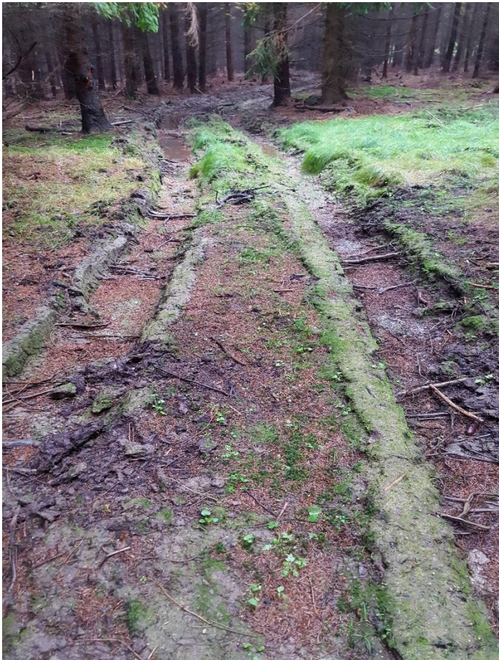
Obrázek 14: Neúměrně vyježděné koleje a zatopení v zadní části na odvozní cestě.
