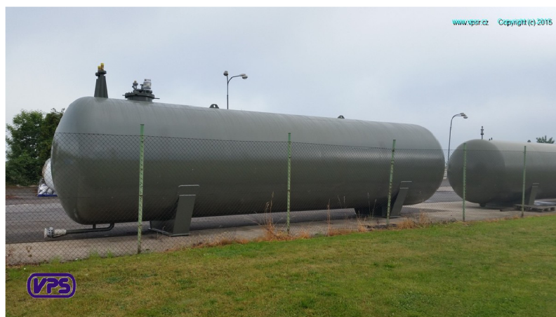
Obrázek 3.12: Tlakový zásobník pro bezpečné skladování LPG, (vpsr.cz, 2022)
