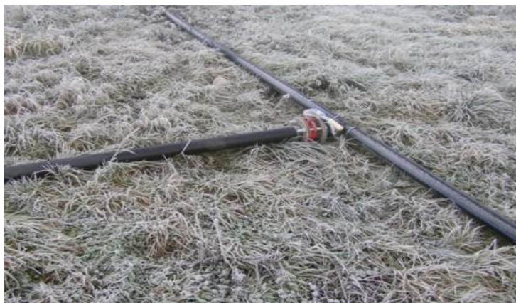
Foto č. 5 - Detail svodného potrubí skládkového plynu (TS Děčín a.s., 2005)
