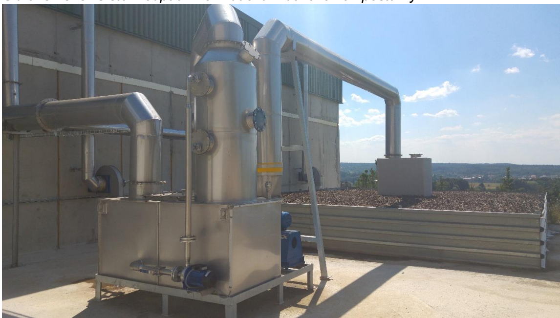
Obrázek č. 8: Čištění odpadního vzduchu z boxové kompostárny
