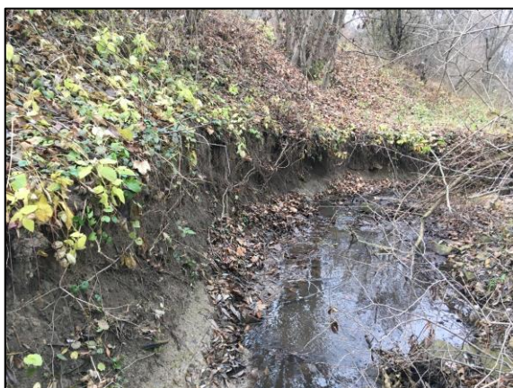
Obr. 42: Břehová nátrž v údolní nivě před obcí Kochavec (foto: P. Škubník, listopad 2021)
