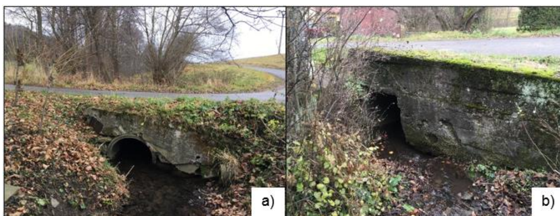
Obr. 32: a) Rizikový propustek před obcí Kochavec, b) rizikový propustek v centru obce Kochavec (foto: P. Škubník, listopad 2021)
