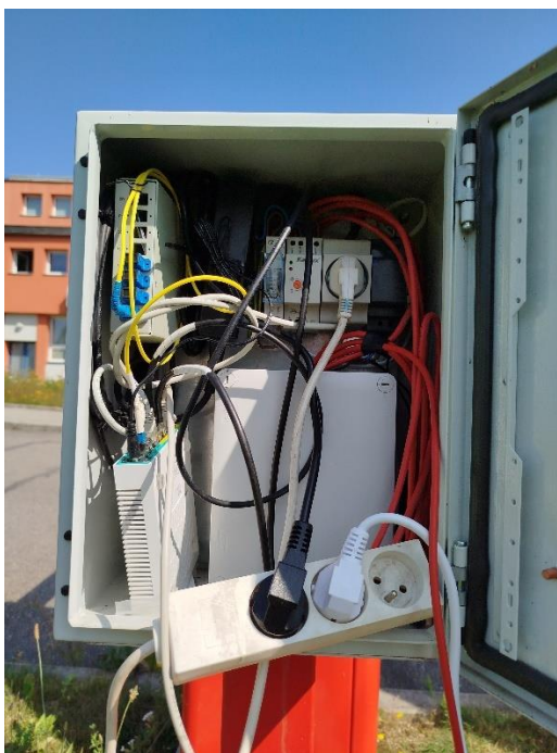
Obrázek 31: Ukázka skříně elektroinstalace při testovacím zapojení
