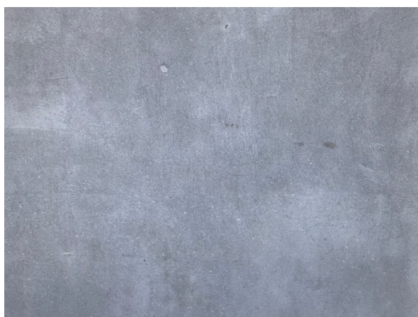
Obr. č. 26: Zaprášení finální vrstvy v ploše fasády; zdroj: vlastní
