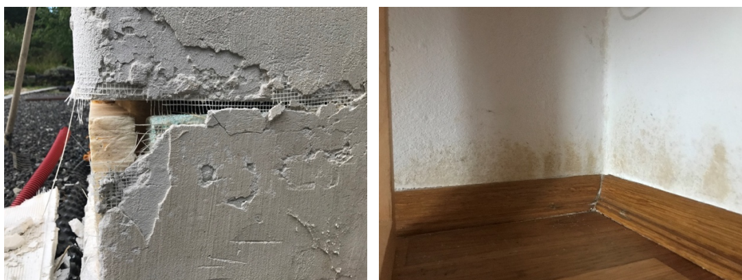
Obr. č. 24 vlevo: Místa tepelného mostu exteriér; zdroj: vlastní
