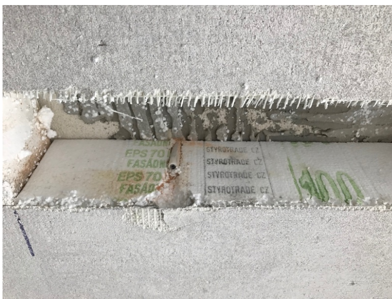
Obr. č. 43: Detail značení použitého izolačního materiálu z EPS; zdroj: vlastní
