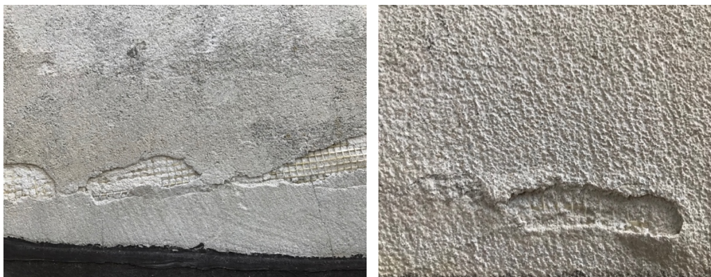
Obr. č. 34 vlevo: Odlupující se místa vrchní vrstvy fasády; zdroj: vlastní
