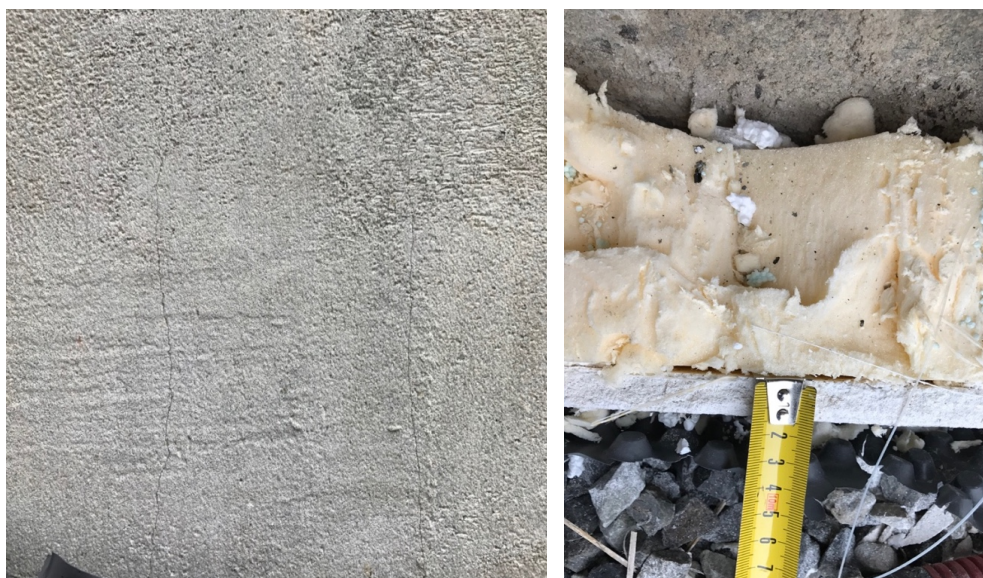
Obr. č. 32 vlevo: Vlásečnicové trhliny v místě soklu fasády; zdroj: vlastní
