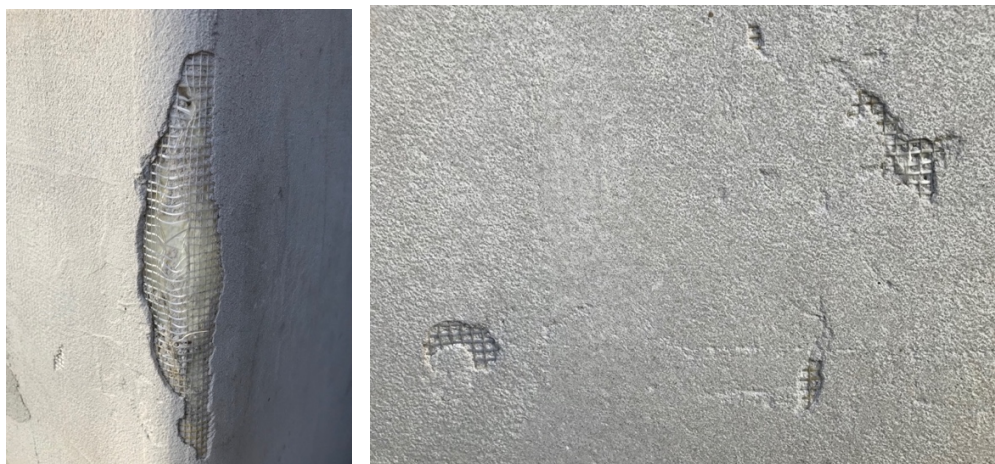
Obr. č. 30 vlevo: Poškození nároží fasády; zdroj: vlastní
