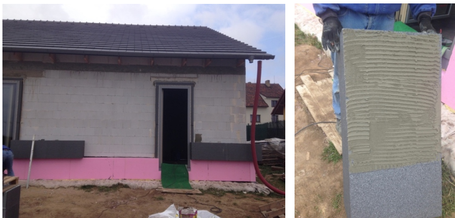
Obr. č. 9 vlevo: Použití pěnového polystyrenu na zateplení fasády domu; zdroj: vlastní
