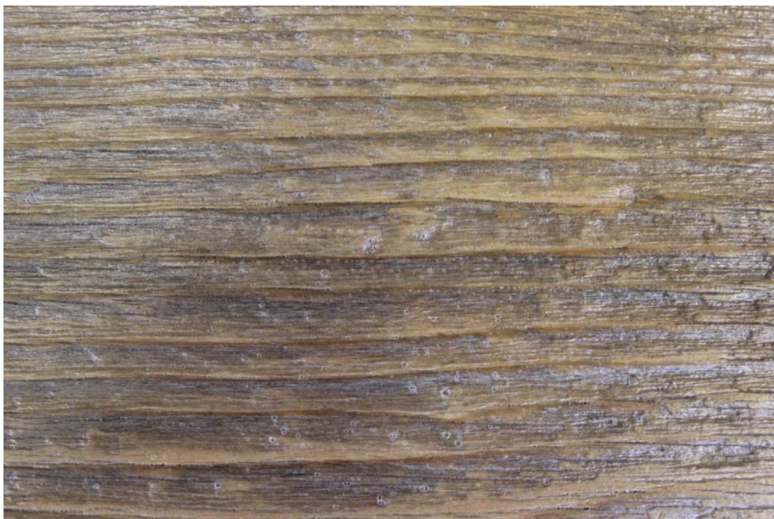
Obr. 28: Povrch zdegradovaného dřeva povrchově dokončen vodou ředitelnou nátěrovou hmotou. Na povrchu vidíme vzniklé bublinky při aplikaci nátěrové hmoty.
