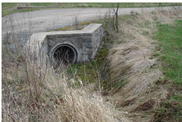
Obrázek 39: Propustek u cesty C2
