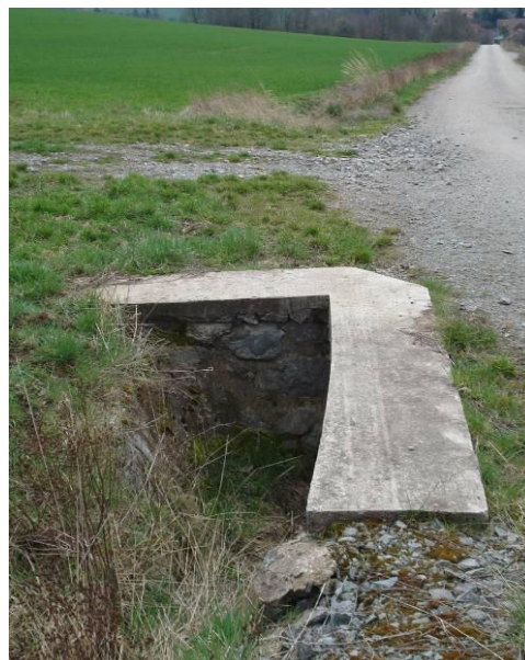
Obrázek 37: Propustek u cesty C1
