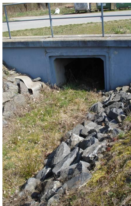
Obrázek 24: Záchytný příkop s propustkem
