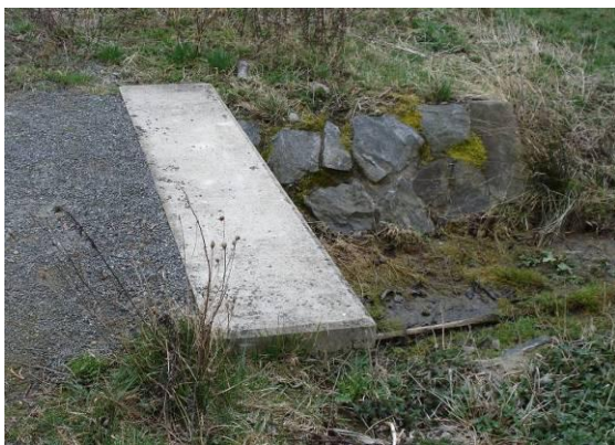
Obrázek 15: Propustek u cesty C2
