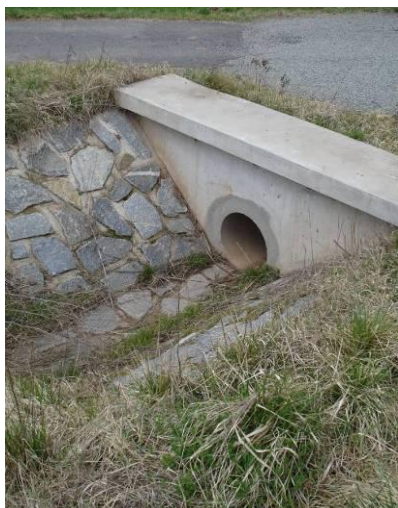
Obrázek 43: Propustek u cesty C4
