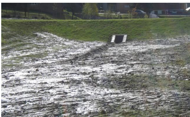
Obrázek 34: Suchá retenční nádrž
