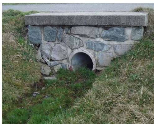
Obrázek 12: Propustek u cesty C1
