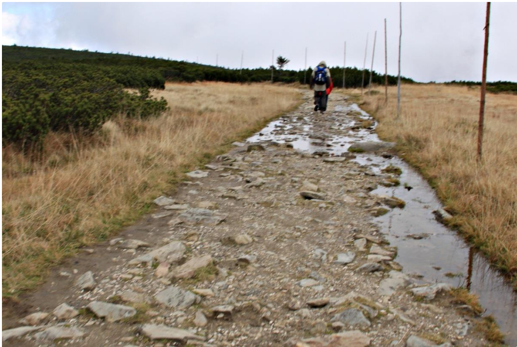
Obr. 33: Původní rozbité těleso chodníku Schustlerovy cesty se špatným odvodněním. Foto autor
