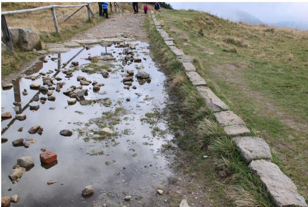
Obr. 7: Špatné odvodnění chodníku mezi Obřím sedlem a Obřím dolem. Foto autor
