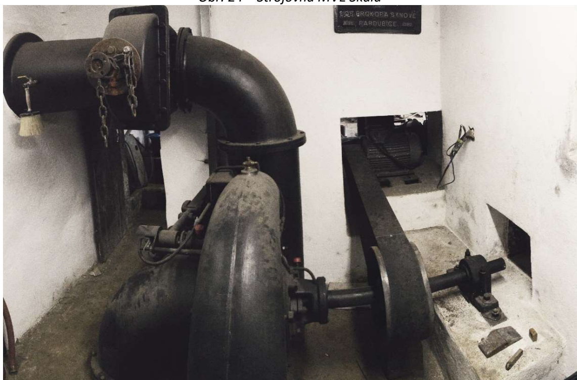
Obr. 24 – Strojovna MVE Skála
