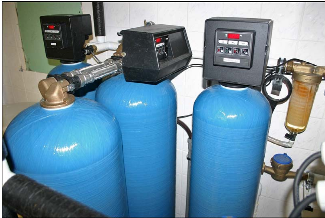
Foto 1. Předúprava vstupní vody
