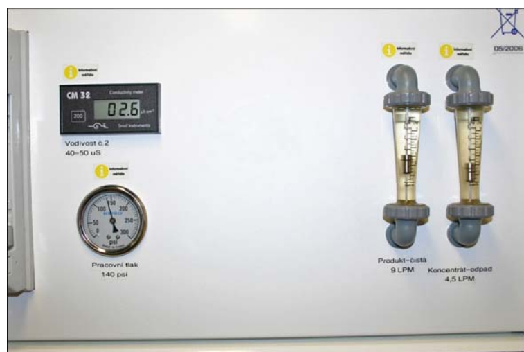
Foto 4. Měření vodivosti, pracovního tlaku a průtoku na jednotce reverzní osmózy
