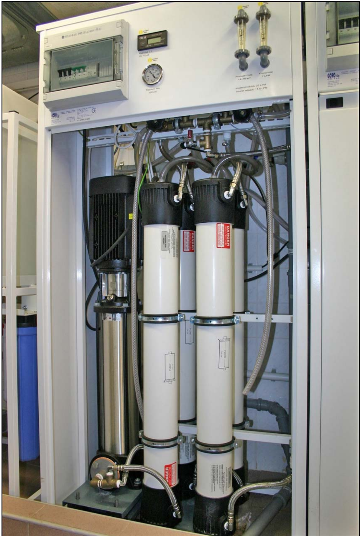
Foto 3. Celkový pohled na jednotku reverzní osmózy
